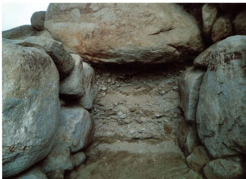
(3) 灌漑用水路出口 土砂堆積状況
